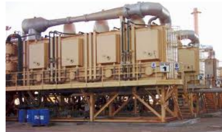
Sea water treatment MED
